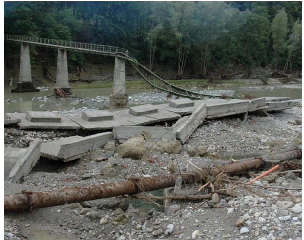
Dégâts causés après la crue au barrage de la Maigrauge © SEn
